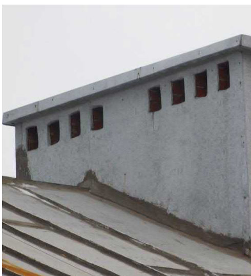
Рисунок 5 – Состояние вент каналов
